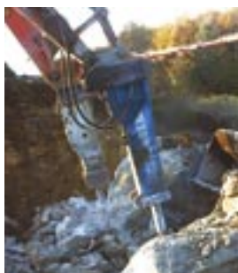
Uniscrap udfører alle opgaver fra demontage af bygninger til opbrydning af fundamenter
